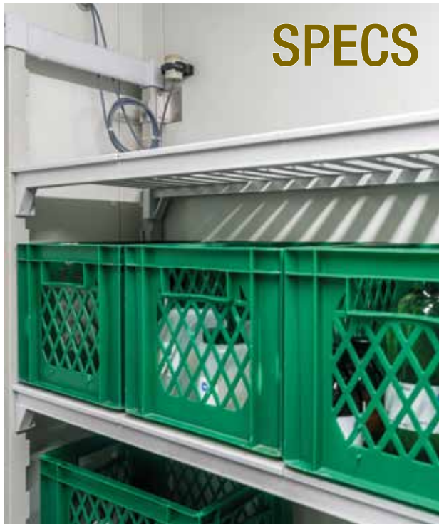
Watermonsters in een gekoelde transportbus van Aqualab Zuid, met links boven monitoringapparatuur van het temperatuurregistratiesysteem Captos van Bitos.
